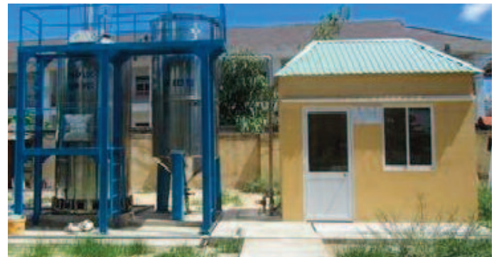
Hệ thống xử lý nước thải tại Bệnh viện Điều dưỡng thành phố Đà Nẵng
